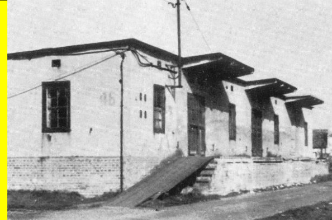
Grafik 17 Dieser Schuppen in A (46) hatte sowohl außen als auch innen Stromkabel. Nur, es kam kein Strom von den Trafos an...
